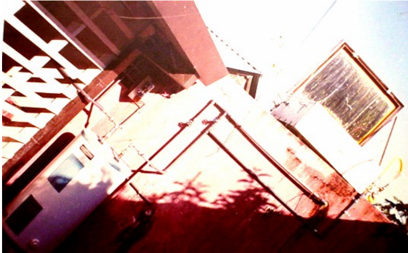
Fig. 5b: Calentador solar de agua- sistema integrado (Pasivo).
